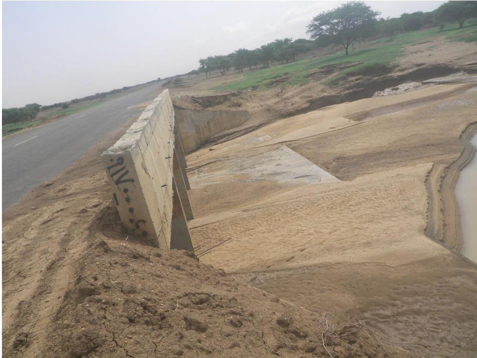
صورة توضح ال Box Culvert الوحيد بمسار الطريق بالموقع رقم 5 بالكيلو رقم 144
