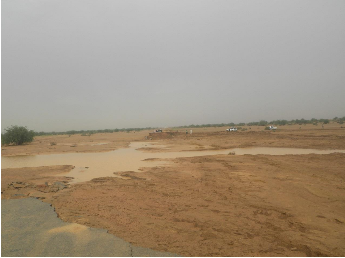
صورة توضح الانجراف الكامل للطريق بمسافة تقارب 200 متر بالموقع 11 الكيلو 181 (Shallow Wadi)
