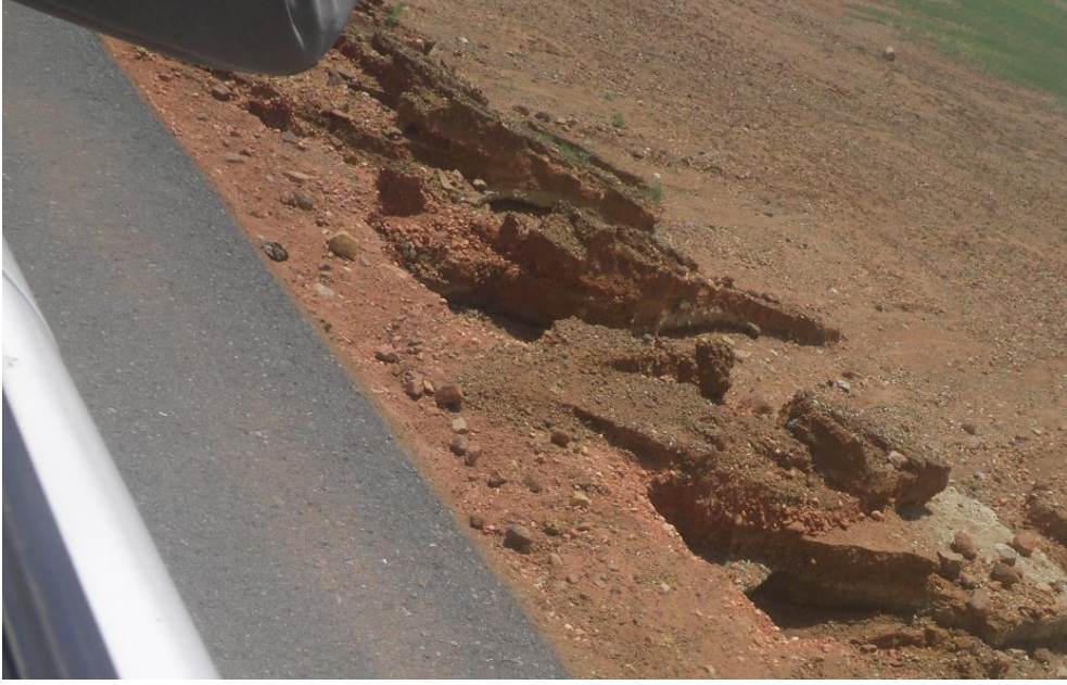
صورة توضح شكل من اشكال التآكل على جانب الطريق بالموق رقم 9 الكيلو 157
