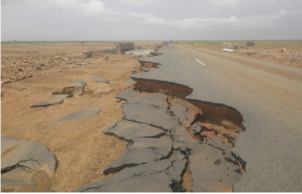
صورة توضح تآكل طبقات الطريق بالموقع رقم 6 بالكيلو رقم 146
