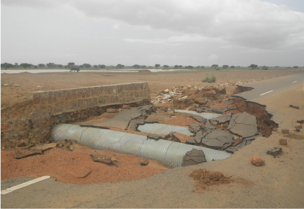
صورة توضح نموذج لتآكل طبقات الطريق بالموقع رقم 7 بالكيلو رقم 149
